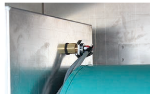
配線接続部には真空装置用のパーツを使用し、漏洩を防ぎます
